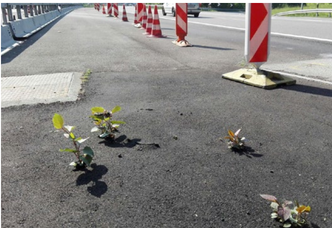
Japanischer Staudenknöterich, der durch kürzlich verlegten Asphalt wächst
