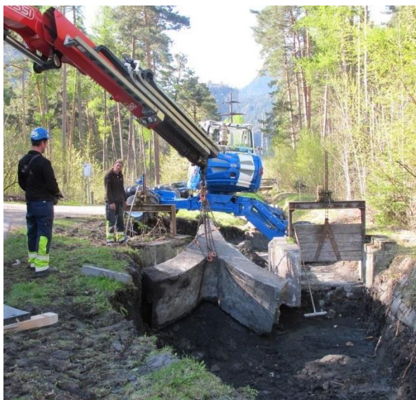
Figura 12: il Polygonon si è infiltrato in un enorme blocco di cemento usato per dividere un sistema di irrigazione. Per rimuovere i rizomi completamente è stato necessario spostarlo. (Foto: Ufficio per la natura e l'ambiente dei Grigioni, 2012)
