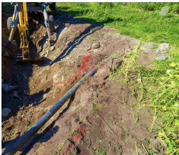
Figura 13: La presenza di condotte, elettriche o di altro tipo, non solo ostacola il lavoro, ma spesso costituisce anche un pericolo per tutte le persone coinvolte. Per questo motivo, durante la fase di pianificazione è essenziale chiarire la questione in anticipo con l'ufficio del registro fondiario, i proprietari fondiari, le aziende di telecomunicazione e gli impianti comunali o locali che producono elettricità. (Foto: Ufficio per la natura e l'ambiente dei Grigioni, 2018)
