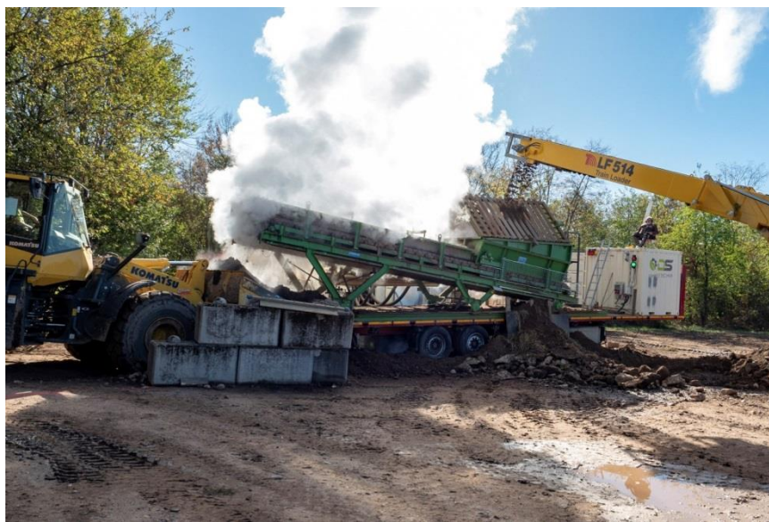
Figura 10: impianto mobile per sterilizzazione a vapore dell'azienda tedesca DS Umwelttechnik GmbH. (Foto: S. Gregori, 2018)
